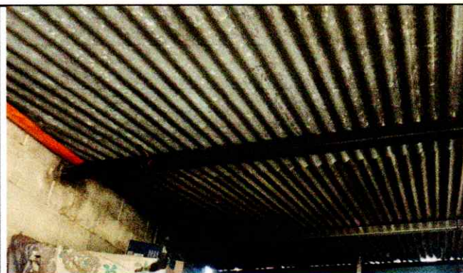
Foto 10: Módulo B, Estructuras en mal estado
