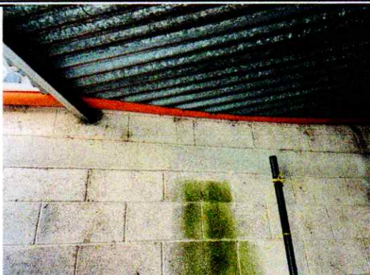
Foto 1: Módulo A, lámina en mal estado
