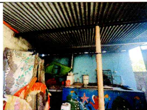
Foto 6: Módulo B, estructura metálica en mal estado
