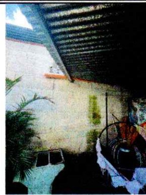
Foto 2: Módulo A, estructura en mal estado
