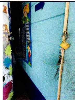
Foto 4: Módulo A, chapa en mal estado
